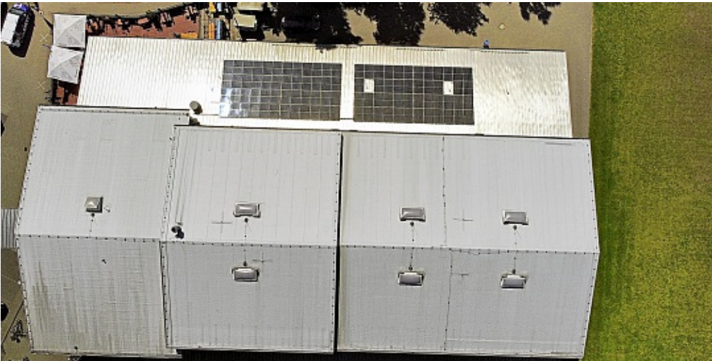
Neue Photovoltaikanlage auf dem Dach der EMTV-Halle am Koppeldamm Foto: Mehmet Karakavak
